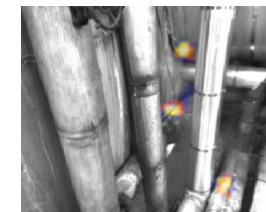
플랜트 산업 배관 유지 보수 (다발성 누설)
