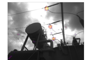
고압전류 송전선 유지 보수 (다발성 부분방전)
