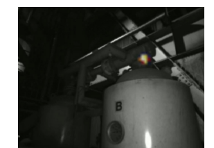
화학 가스 저장탱크 유지 보수 (가스 누설)
